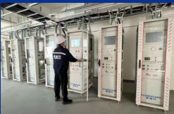
设备现场实拍
