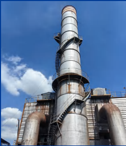
设备现场实拍
