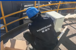
设备现场实拍
